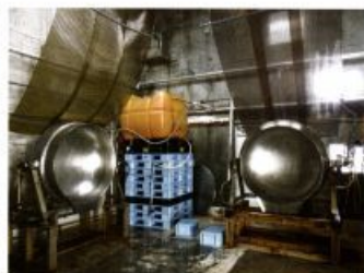
析出用蒸気釜
