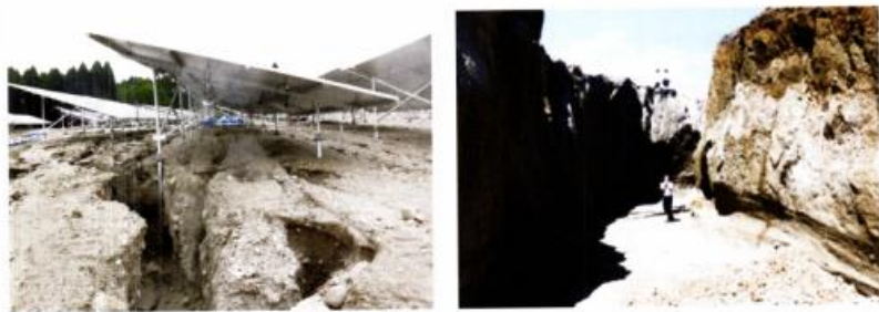
造成前の確認不足により、土砂が流出し、大きな「みずおち」が出来てしまった例。後々のトラブルにつながってしまう
